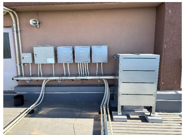
パワーコンディショナ・蓄電池等
