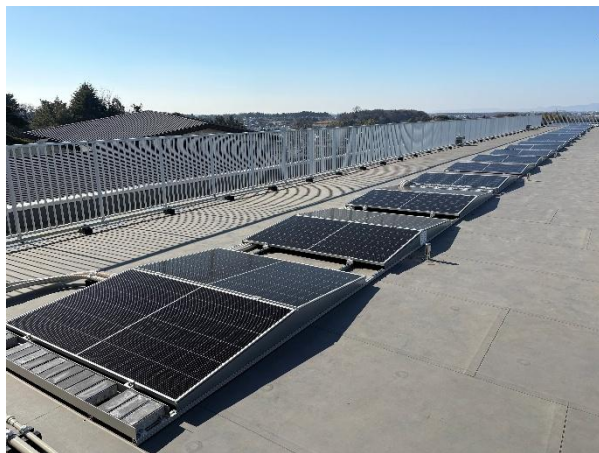
太陽光パネル
